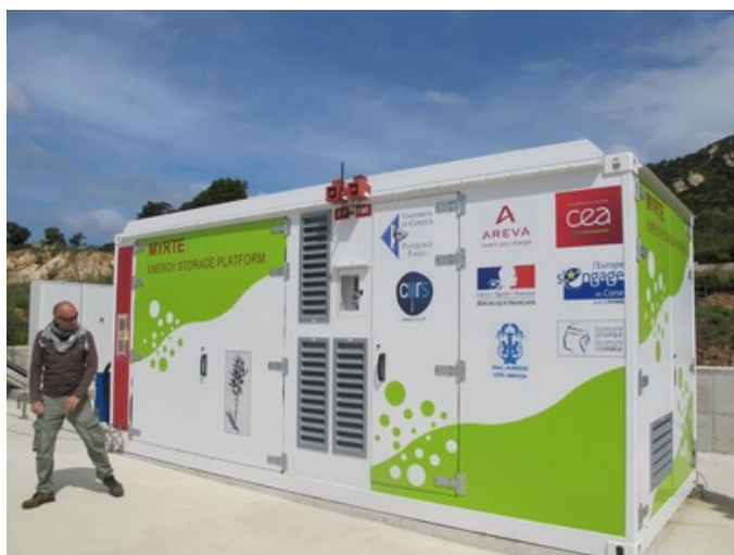
Figure 46. Electrolyseur + PAC dans un conteneur
