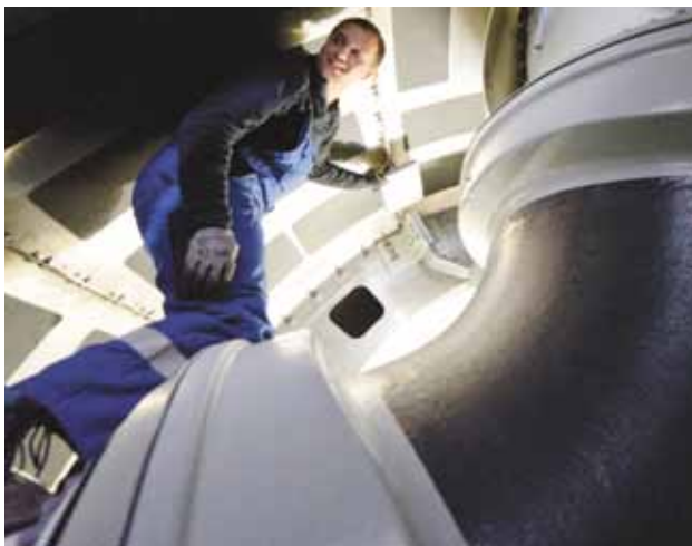
Une maintenance régulière doit être mise en œuvre pendant toute la durée de l'exploitation (estimée à 20 ans).
